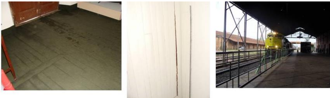
Figuras 18,19 e 20 – Sinais de infiltração no espaço expositivo e deslocamento de forro provavelmente por trepidação do trem
